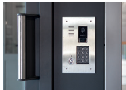
Technische Säule mit Gegensprechanlage
